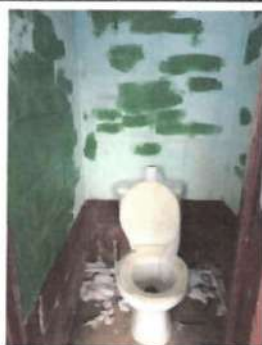
Foto 5: Sustrucción de accesorios de sanitarios, incluye accesorios internos, externos, tapa y asiento.
